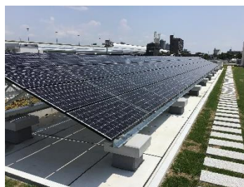
図1-6 香榎園小学校の太陽光発電設備
