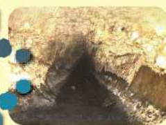
下水道管内の油脂 付着状況
