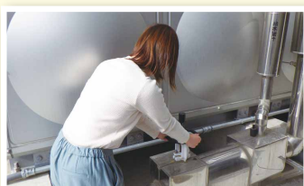
バルブの閉栓
