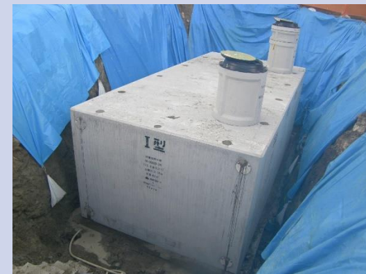
（耐震性防火水槽）
