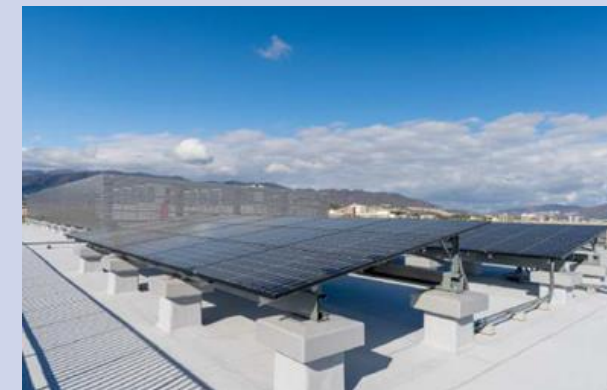
（太陽光発電設備）
