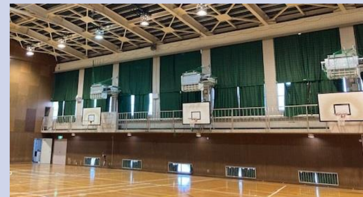
（空調設備整備後の体育館）
