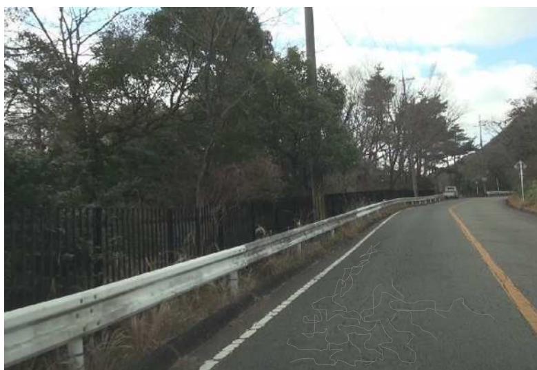
ひび割れのイメージ写真
